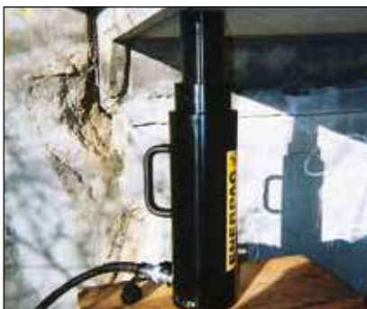
◀ Переносний циліндр RACL-1506 зі стопорною гайкою, що використовується для утримання вантажу під час заливання епоксидної смоли під час укріплення мосту.
