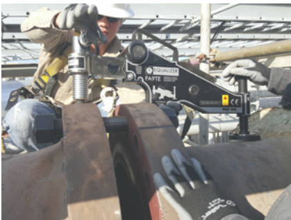
Компанія, яка використовує Гідравлічний вирівнювач для фланців Equalizer FA9TE на майданчику в Техасі
